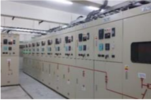
105 年度電力系統改善工程-第一主變電站高低壓配電盤及電力變壓器高壓配電盤、高壓變壓器、低壓變壓器
